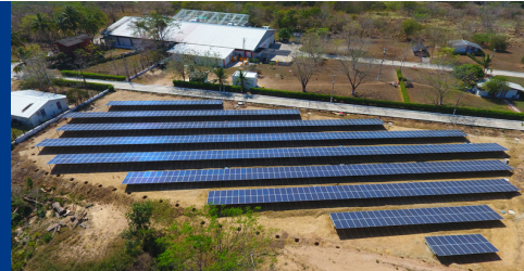
327 KwP en piso Sabanalarga Atlantico Colombia
